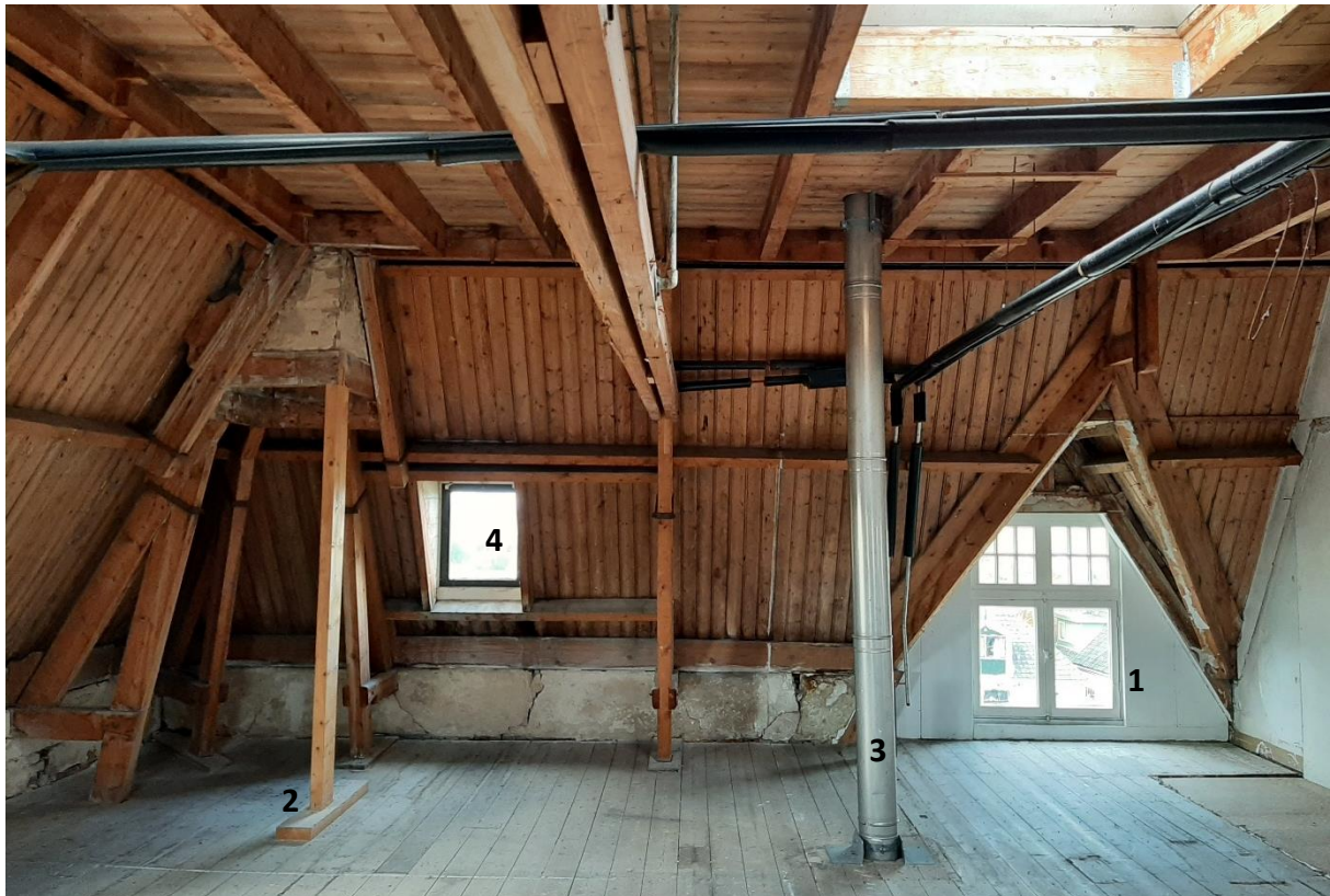
Boven: 02 Kapconstructie van de zolder aan de straatzijde. Middenvenster van de Vlaamse gevel(1). De schoorsteen wordt extra ondersteund door recent geplaatste stijl op slof (2). Stookkanaal van de haard in de woonkamer (3). Kleine dakkapel in in het westelijke dakvlak zonder roedeverdeling (4)
